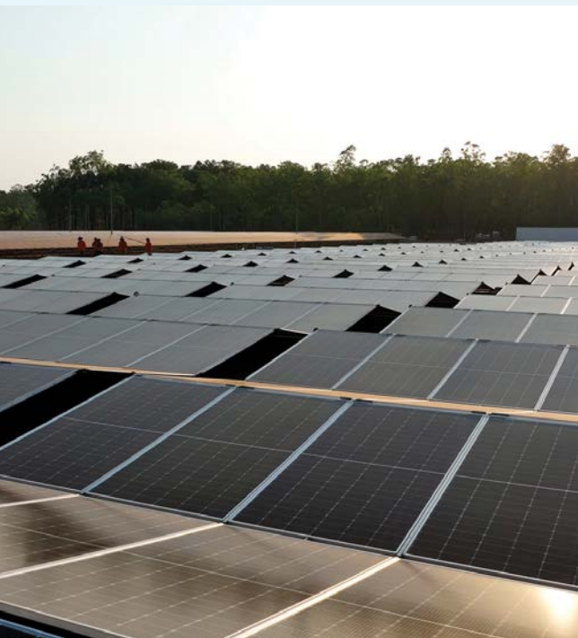
Wurrumiyanga solar array.
